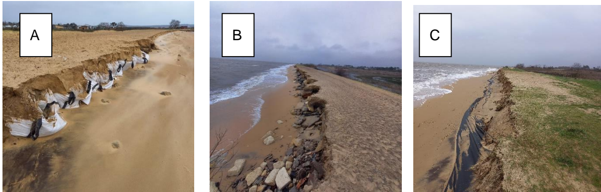
Figure 24 - Digue des Prés salés Est, casier est. A et B : découverte des « Big bags » et lentilles d'érosion à l'ouest de l'écluse, C : géotextile à l'est de l'écluse. © Syndicat Intercommunal du Bassin d'Arcachon
