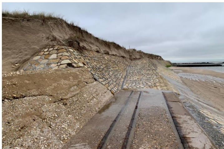
Figure 6 - Érosion en sommet d'ouvrage au nord des Arros. Photo prise le 08/02/2021. © Observatoire de la Côte Aquitaine
