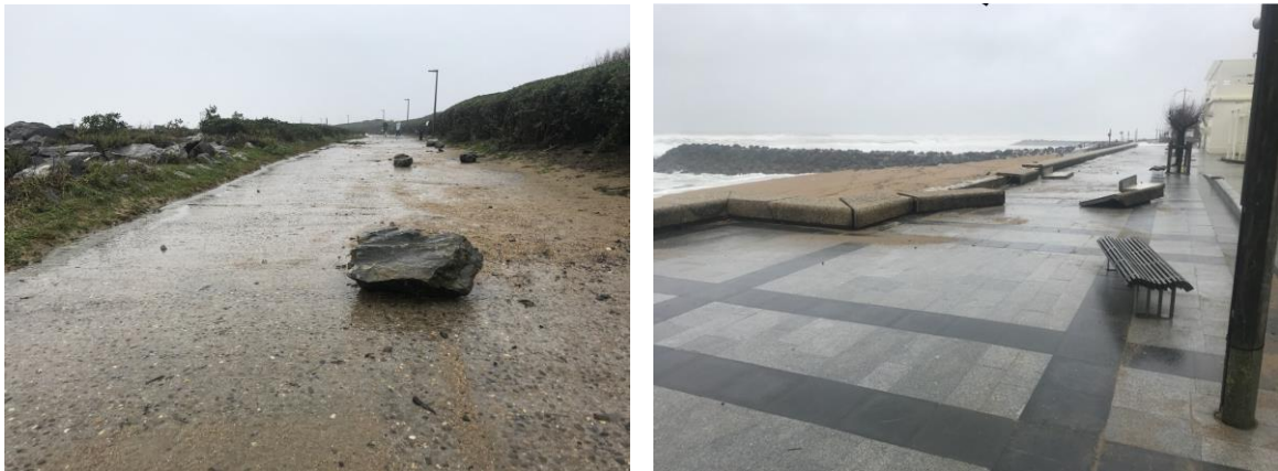
Figure 35 - À gauche : Déplacement de blocs au niveau de l'enrochement des Cavaliers. À droite : Destruction ponctuelle du revêtement du muret de protection au niveau de la plage du Club. Photos prises le 31/01/2021. © Université de Pau et des Pays de l'Adour
